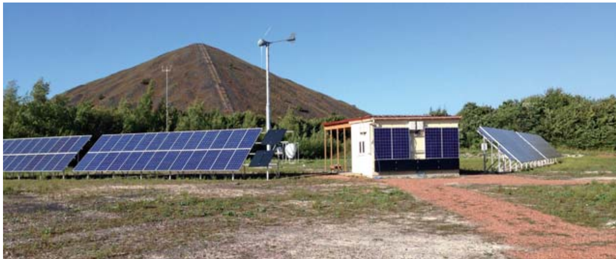
La phase 2 de Lumiwatt (Loos-en-Gohelle) permet de tester la complémentarité de l'électricité produite par des éoliennes avec l'électricité produite par les nouveaux panneaux photovoltaïques et teste différentes technologies de stockage et d'usage.
