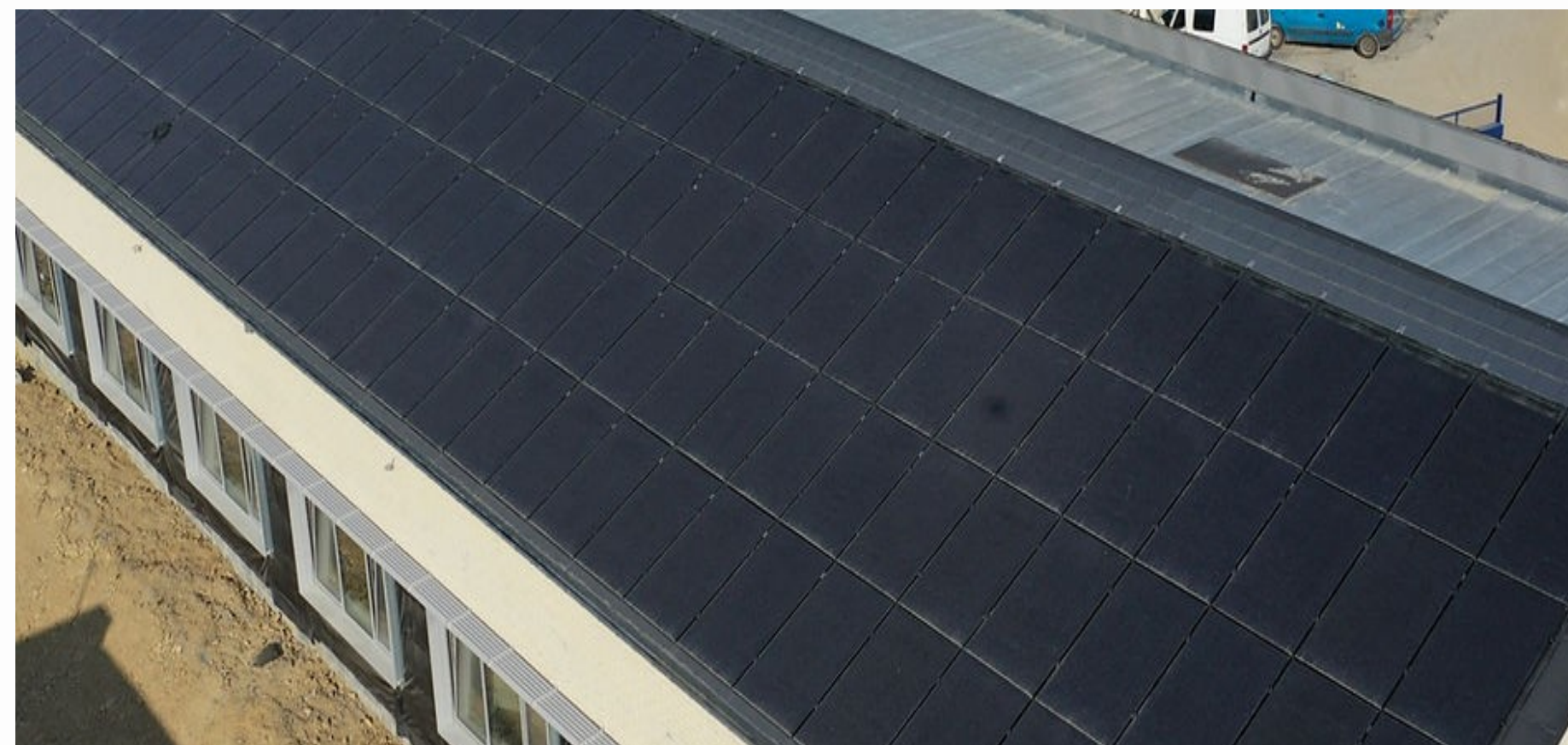
Centrale photovoltaïque de l'école Aragon-Mendès
